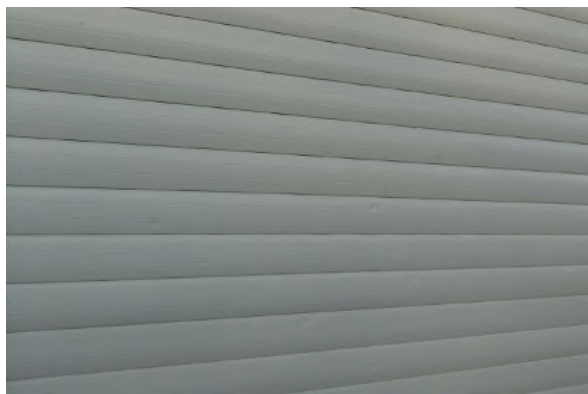
5. Oštećenja na roletama uslijed tuče
