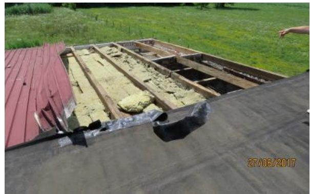
4. Šteta na krovu od oluje – foto sa krovišta
